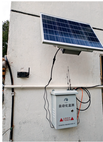
苏州生命线工程古建及危房安全自动化监测
