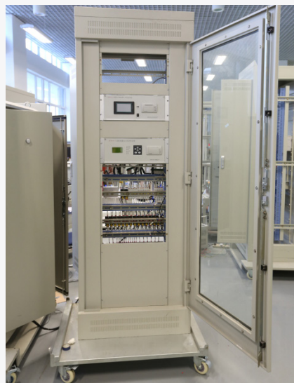
统一控制及选线装置
