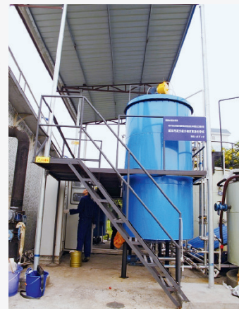
建成的中试系统
