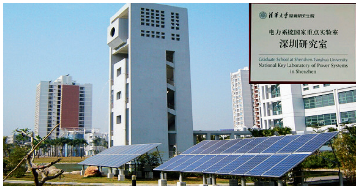
清华大学深圳研究生院的光伏扬水系统研究示范基地
