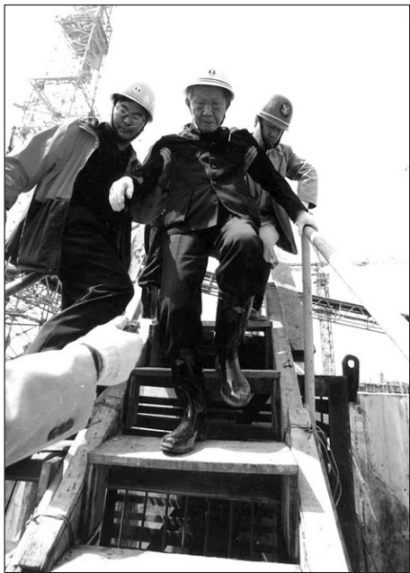
三峡工程开工后，年近九旬的张光斗（中）每次检查三峡工程质量，都要艰难地下到施工仓面，亲自观察混凝土浇筑情况
