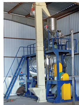
机械力化学处理设施
