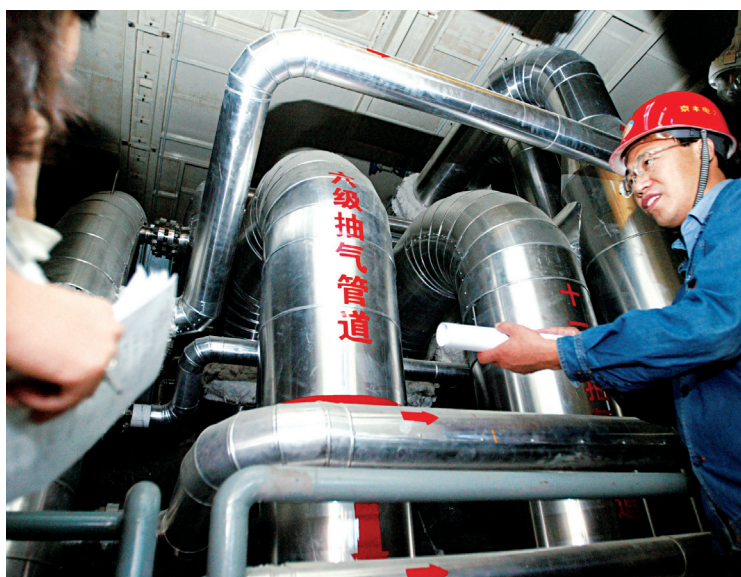
北京某热电厂的天然气发电工程
