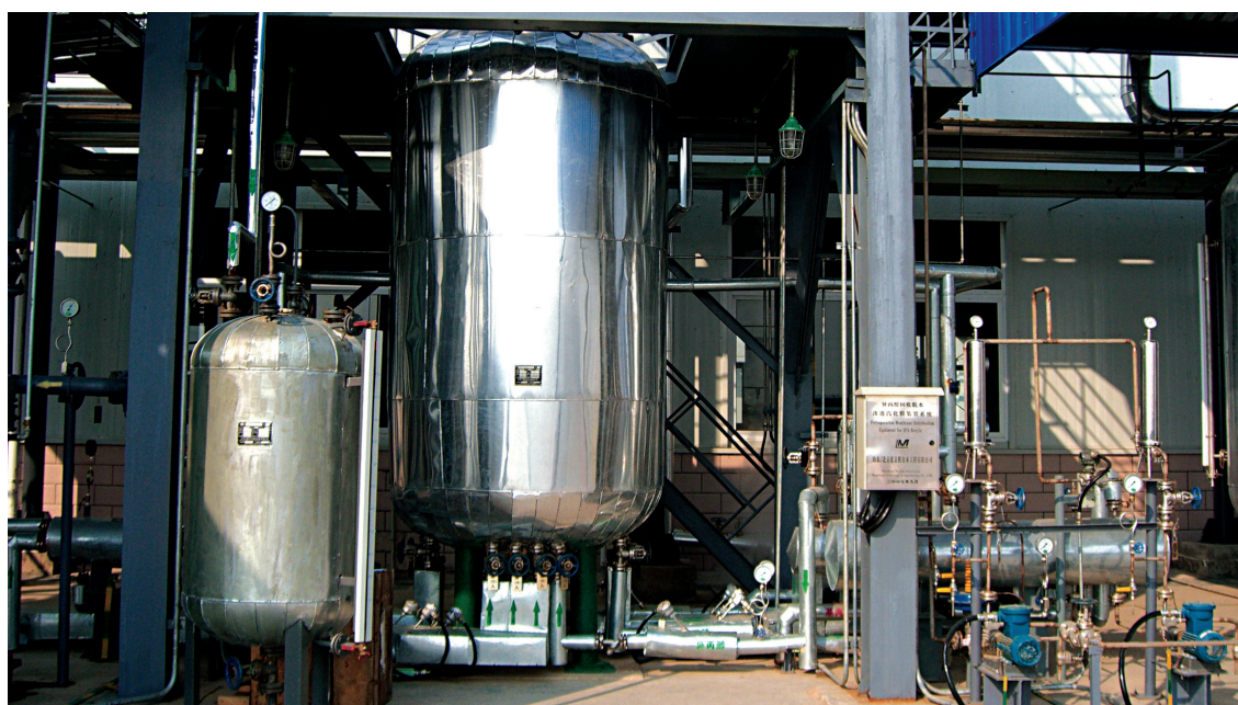
常州高博能源材料公司18000吨/年正丙醇脱水渗透汽化工业装置
