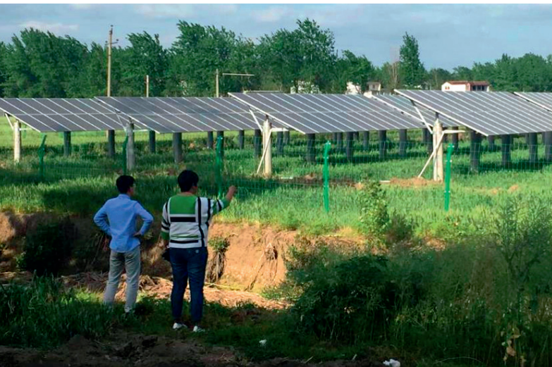
河南新蔡的光伏扶贫项目建设
